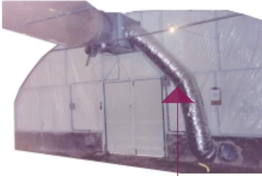
Ducto de aire acondicionado conectado al ducto de ventilación
