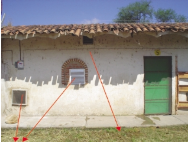
Ventilas de fuga de presión
